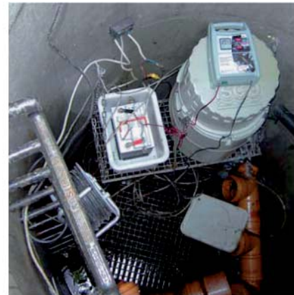
Probenehmer mit Durchflussmesser im Ablaufschacht
