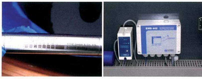
Bild 10 Füllstandsmessung Hydrolevel (links) und Messwertumformer (rechts)
