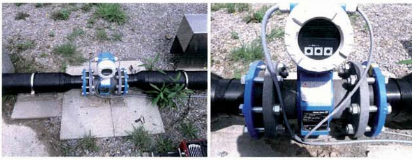
Bild 9 Durchflussmessung Zulauf „heavy traffic“
